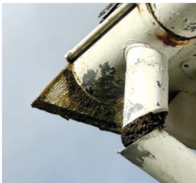
Bilde 32. Skadet taknedløp
