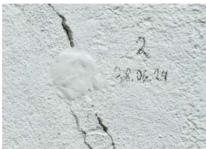
Bilde 38. Gipsplumbe over sprekk
