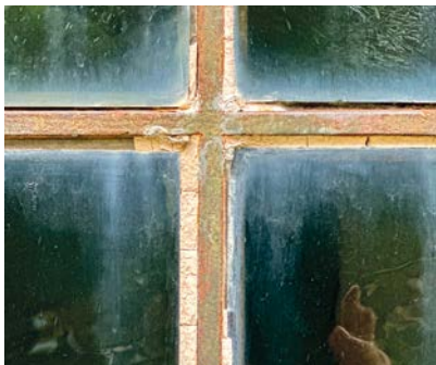
Bilde 21. Manglende kitt på glass
