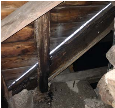
Bilde 7. Råte i takkonstruksjon
