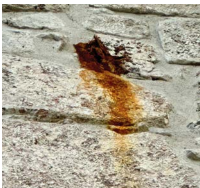
Bilde 27. Korrosjon på vegg
