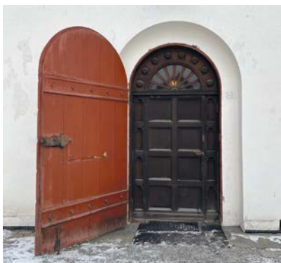
Bilde 25. Skrapeskader på dør
