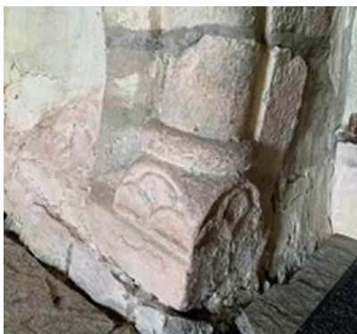
Bilde 39. Bruk av feil mørtel
