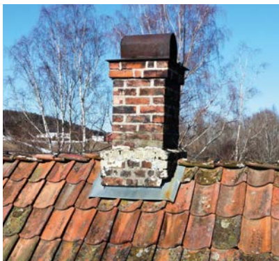
Bilde 28. Feil mørtel på pipe
