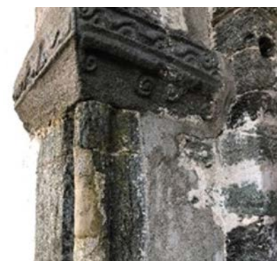
Bilde 40. Bruk av feil mørtel
