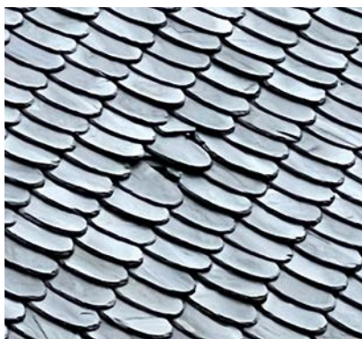
Bilde 14. Manglende skiferstein
