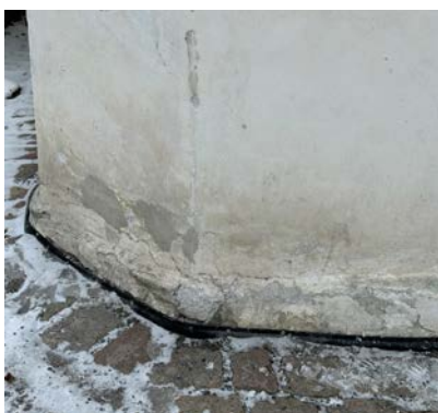
Bilde 3. Forvitring av sokkel
