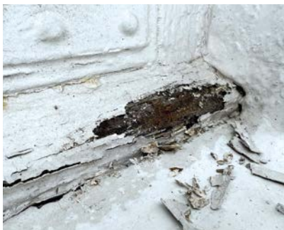
Bilde 20. Råte i karm
