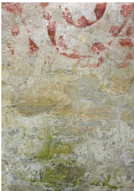
Algevekst, og rester av røde kalkmalerier, på indre side av yttervegg.
