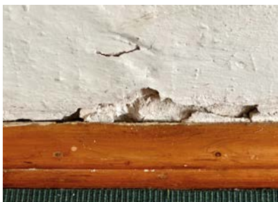
Bilde 10. Saltutslag på innervegg
