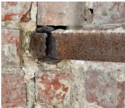
Bilde 26. Brekkasje av stag
