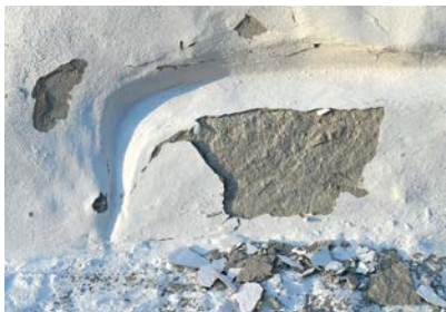
Bilde 9. Forvitring av kalkmaling
