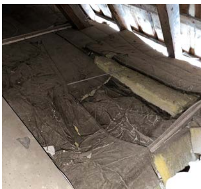
Bilde 31. Følgeskader fra isolering
