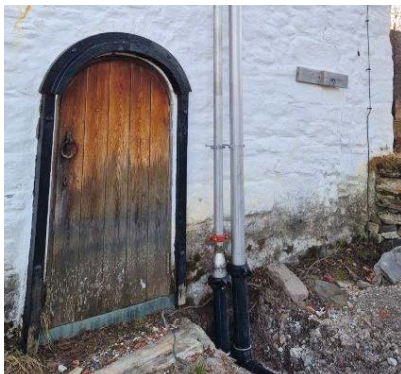
Bilde 22. Sprutende regn på dør
