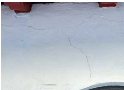
Bilde 11. Riss over vindu
