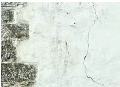
Bilde 37. Riss i fasade
