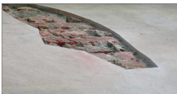
Gammel murgård under rehabilitering. Skader i pussjiktet er skåret bort. (Foto: W.Knudsen)
