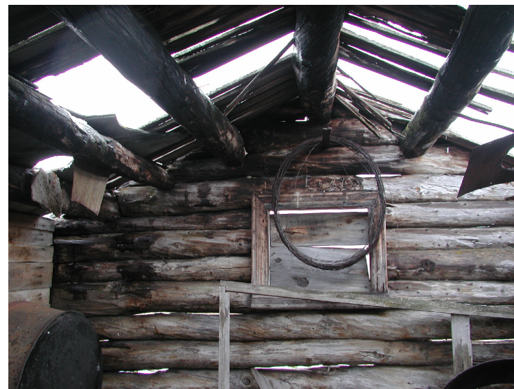
Huset er laftet uten medrag, veggene er utette.
