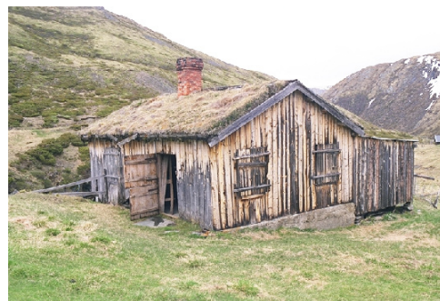
Ysteribygningen fra før reparasjonen. Torvtaket lekker og har gjort det i lang tid. Det er store råteskader i takkonstruksjonen.
