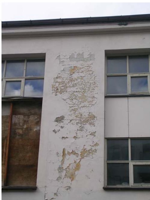
Her er det brukt en tett, organisk maling (plastmaling) oppå gammel kalkmaling. Fukten i murverket kommer ikke ut før malingsfilmen revner.
