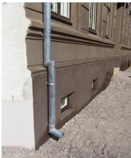
Tradisjonelt nedløpsrør i sink med loddede ben følger fasadeen tett og holder vannet unna.
