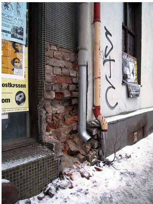
Bygninger krever ettersyn. Enkle tiltak til rett tid kan hindre store og kostbare skader. Hadde rørstumpen til 200 kr kommet tre år før, ville mange utgifter vært spart.
